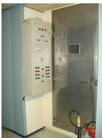
Εικόνα 3. Εργαστήριο Φυσικοχημείας: Ψυκτικός θάλαμος
